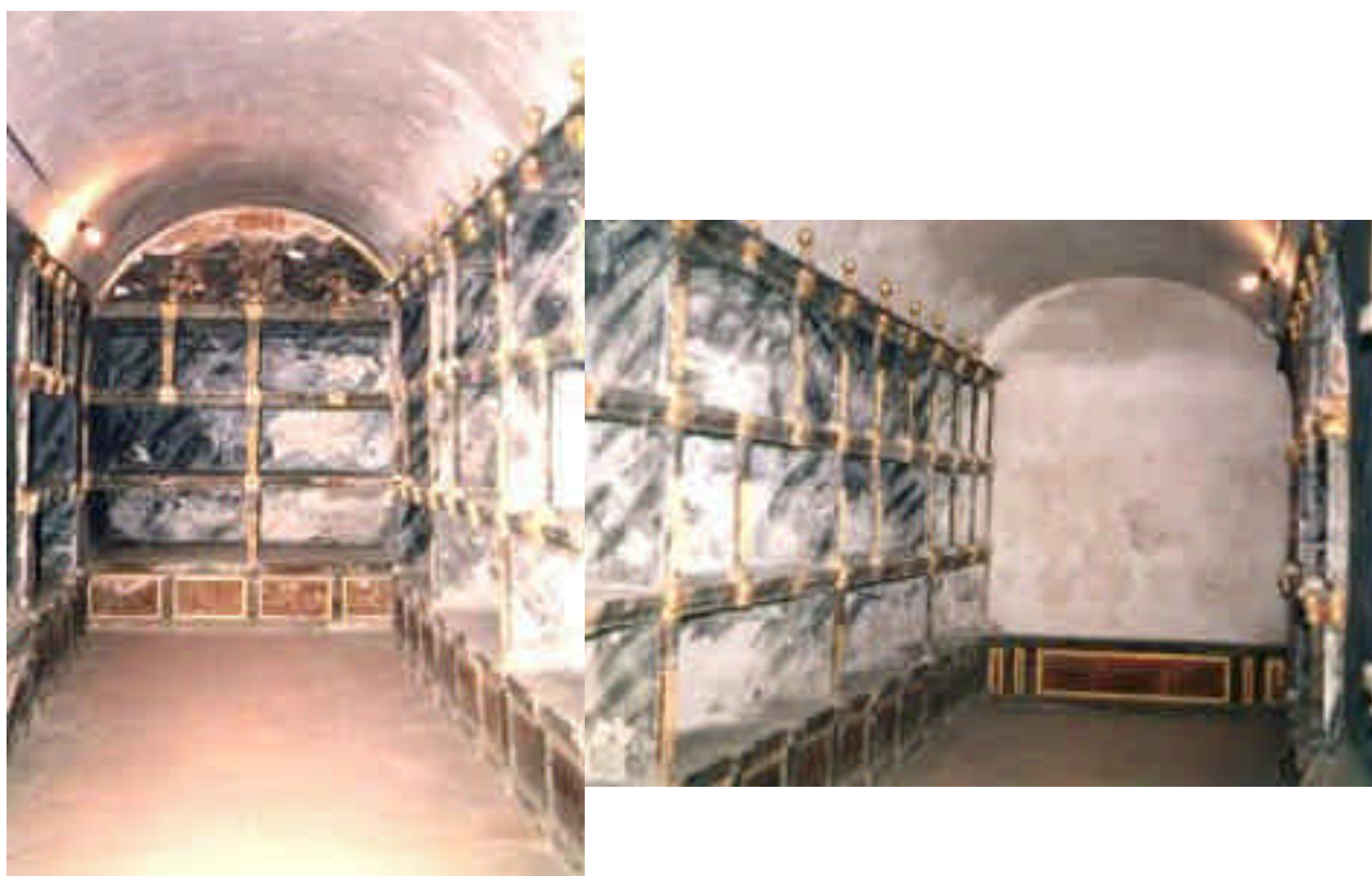
Láms. 3 y 4: Antigo Panteón de Infantes del siglo XVII. El estuco, la madera dorada y el fresco de encima de las tumbas en su parte superior están en muy mal estado. La ventana que ha quedado prácticamente tapada, comunicaba el coro del siglo XVI con la capilla.
